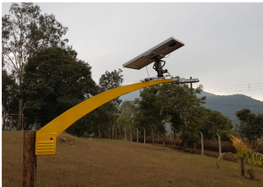
FIGURA 3 – Vista Superior do Poste Fotovoltaico com o Seguidor Solar
